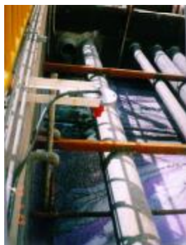
Pomiar poziomu w zbiorniku otwartym na oczyszczalni ścieków
