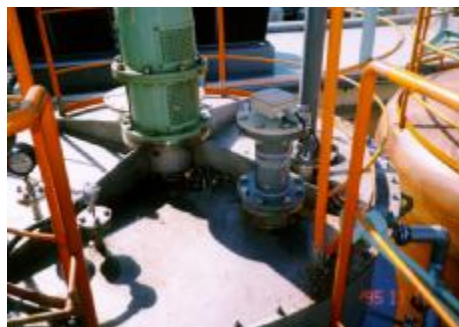
Pomiar poziomu kwasu siarkowego w zakładzie chemicznym
